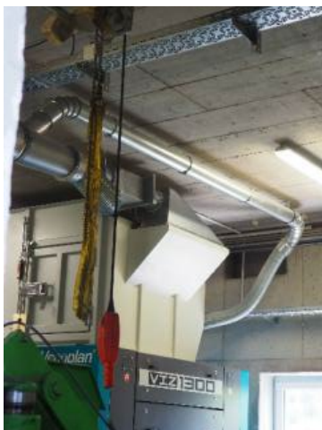
Photo 5 : ce qui manquait au spécialiste allemand de la destruction de documents, c'était de la place. Vecoplan a dû adapter le VIZ à la faible hauteur sous plafond.
