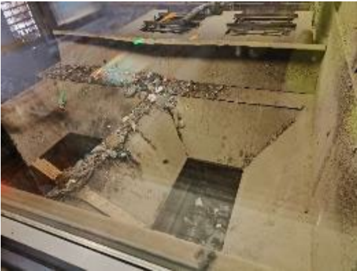
Bild 5: Der VVZ wird über den Einfülltrichter beschickt.
