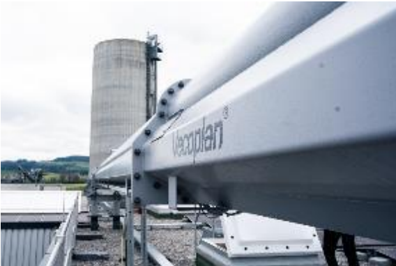
Bild 5: Außerhalb des Gebäudes sorgen Kratzketten- und Rohrgutförderer von Vecoplan für den staubfreien Transport des aufbereiteten Materials bis zum Pelletwerk.
