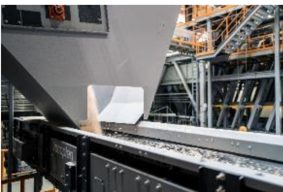
Bild 4: Die von Vecoplan installierte Fördertechnik transportiert das Material im Inneren der Entsorgungslinie kontinuierlich und sicher.
